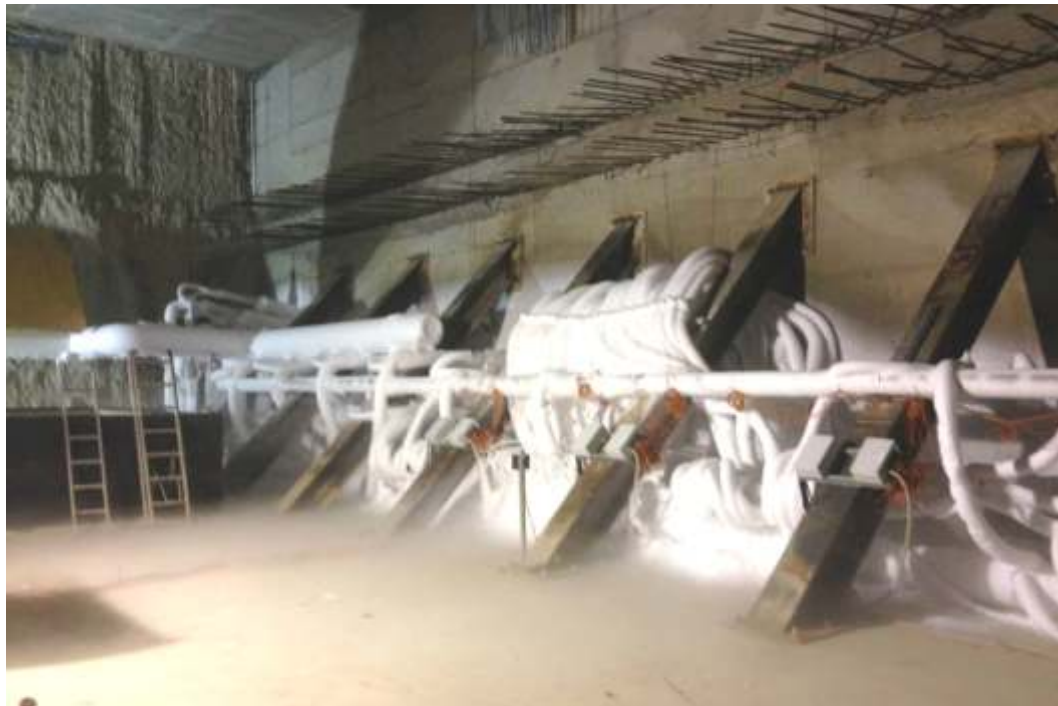
Circuito distribuzione dell'azoto - Pozzo ovest
